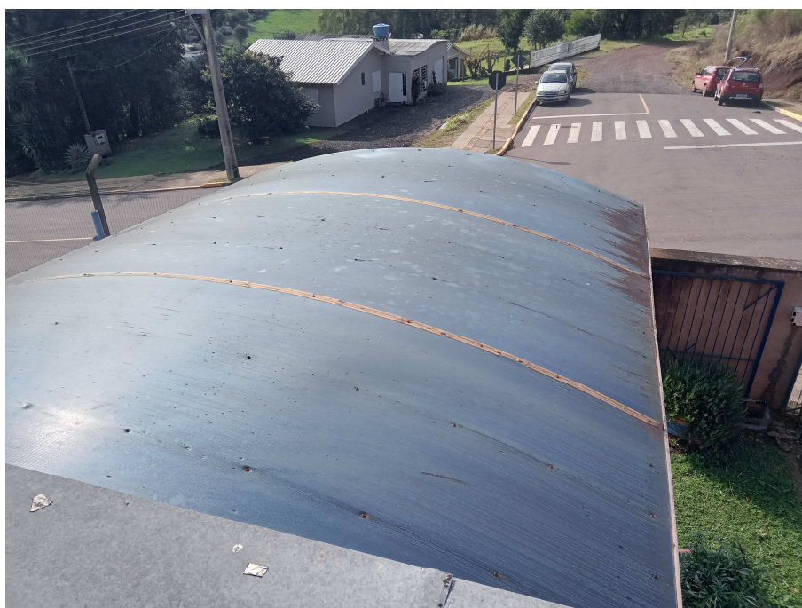
Imagem 06 – Chapas de Policarbonato 6 mm danificadas.
