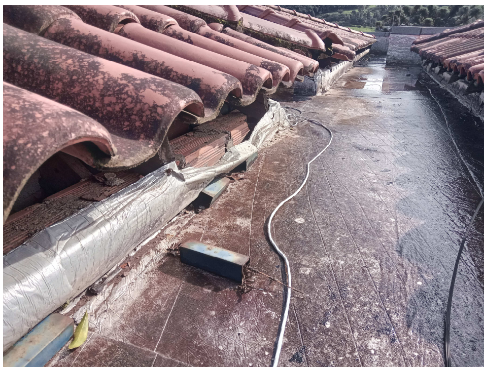
Imagem 09 – Descolamento das mantas.
