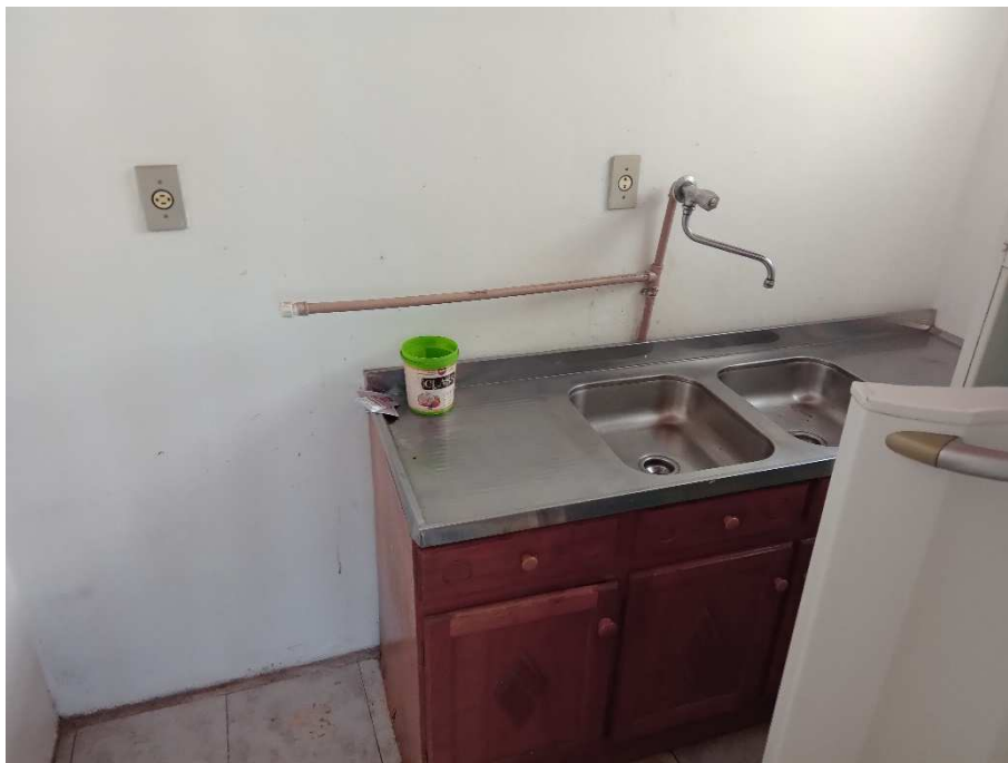
Foto 2 – Canalização a ser reparada.
