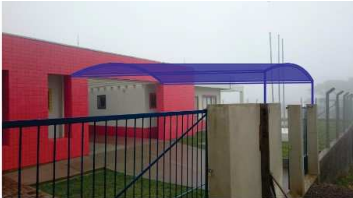
Imagem 05 – Local a ser substituído as chapas de Policarbonato 6 mm.
