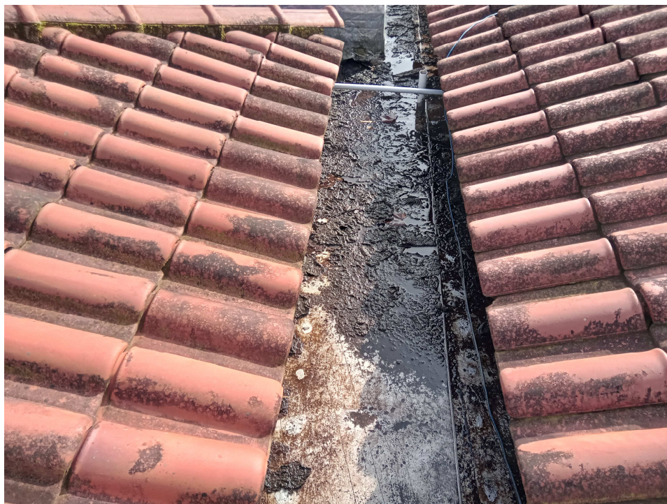
Imagem 08 – Presença de sujeira nas calhas.
