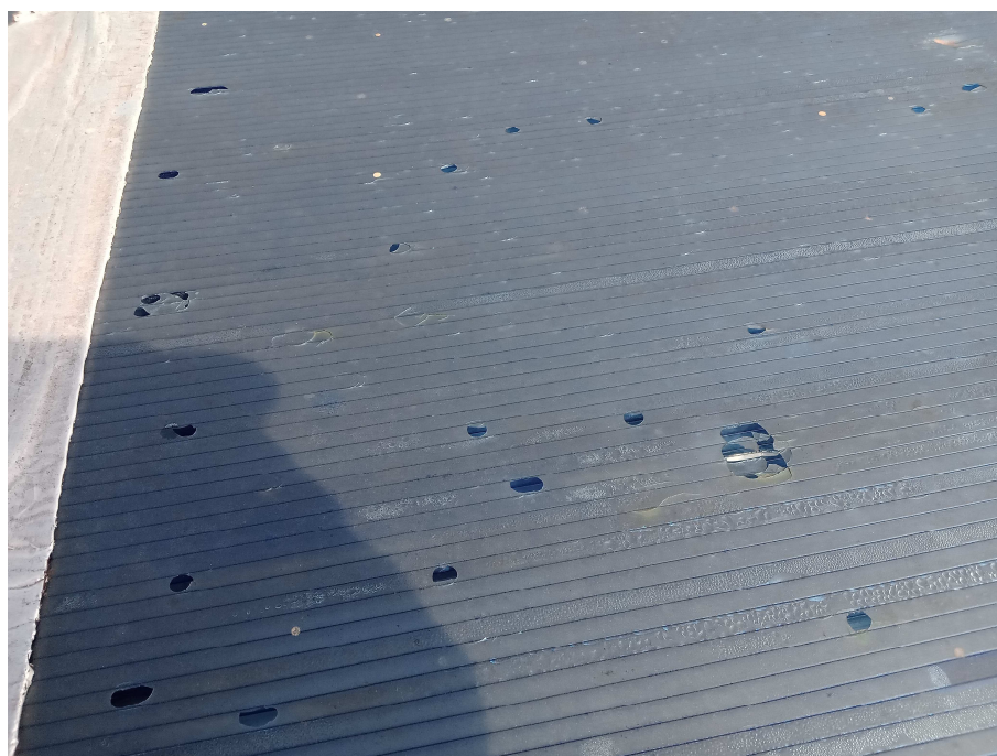
Imagem 04 – Chapas de Policarbonato 6 mm danificadas.
