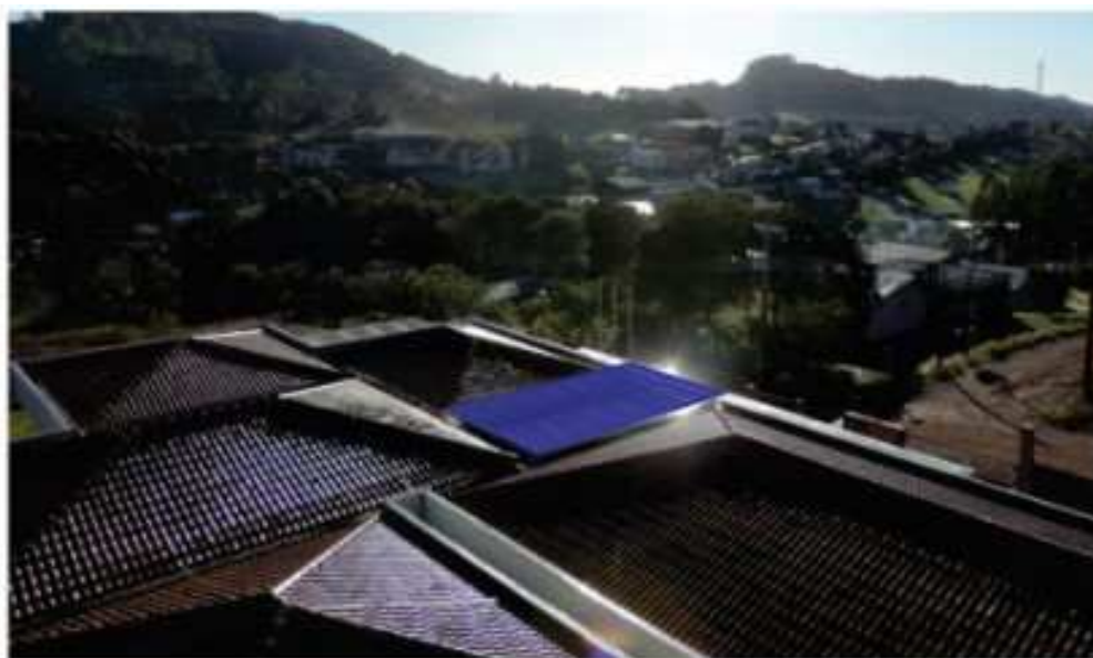
Imagem 03 – Local a ser substituído as chapas de Policarbonato 6 mm.
