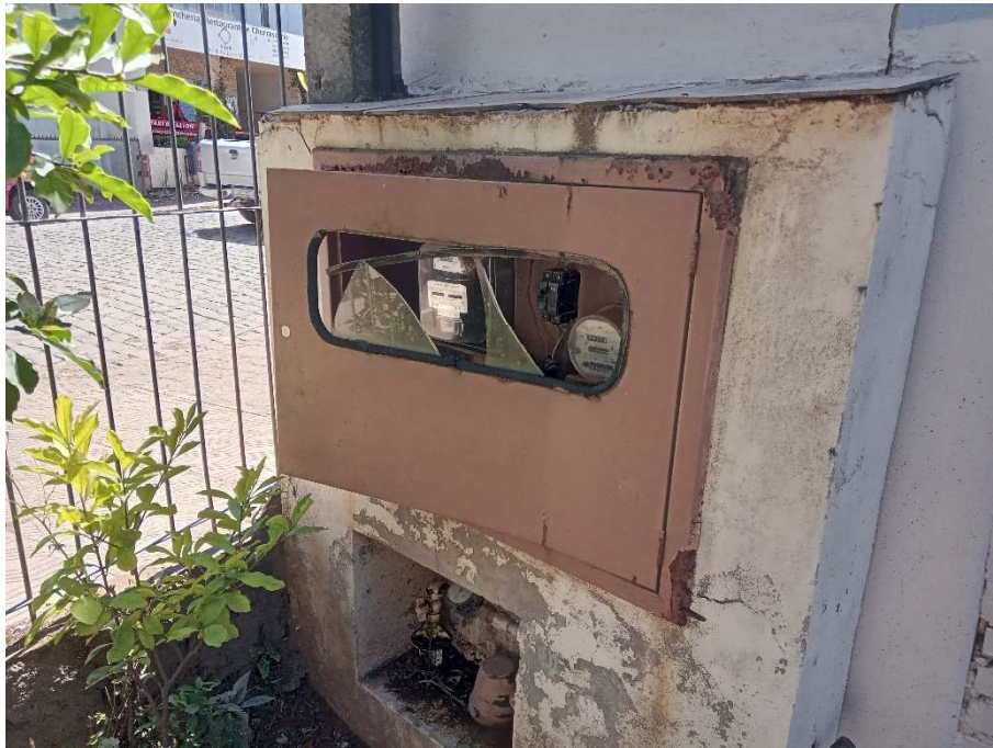
Foto 6 – Quadro de entrada de energia a reformar.
