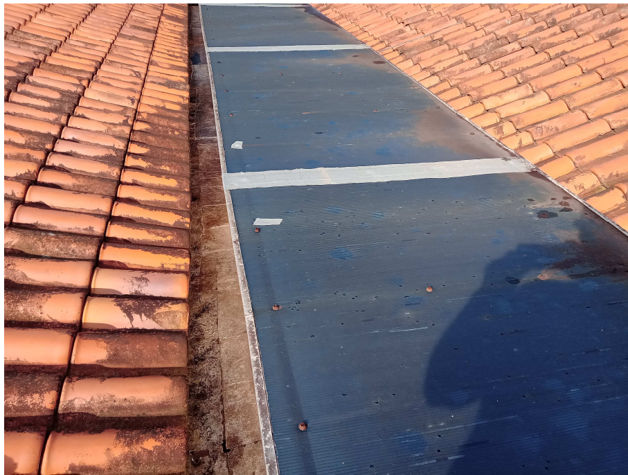
Imagem 02 – Chapas de Policarbonato 6 mm danificadas.
