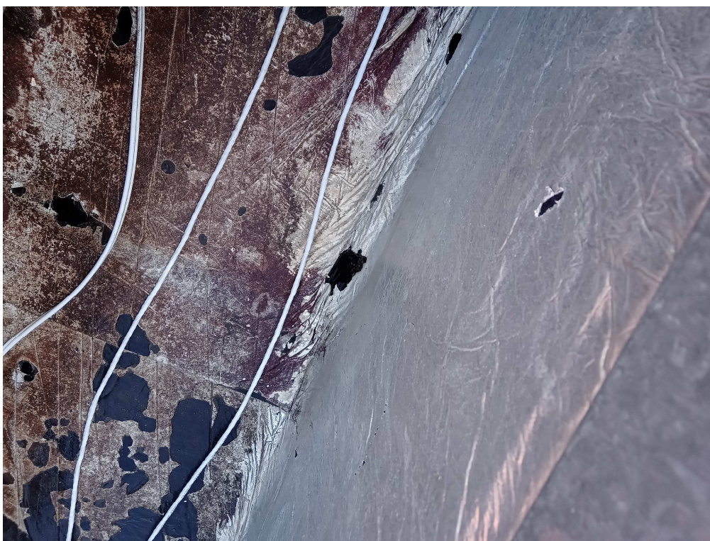
Imagem 07 – Presença de buracos nas mantas.
