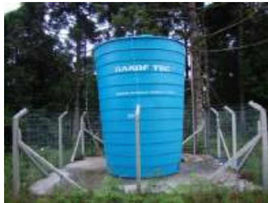
Figura 3.37 – Cercamento do Reservatório do SAA Linha Fernandes 2
