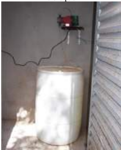
Figura 3.38 - Bomba dosadora de soluções de cloração
