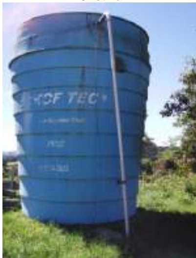
Figura 3.68 – Reservatório do SAA Linha Cristina
