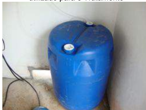
Figura 3.11 – Armazenamento do cloro utilizado para o Tratamento
