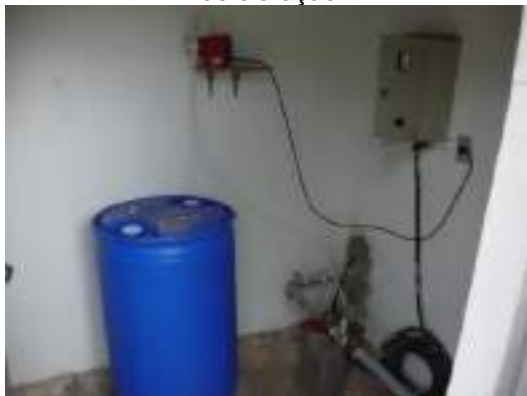
Figura 3.34 - Bomba dosadora de soluções de cloração
