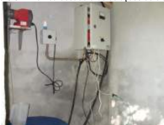
Figura 3.62 - Bomba dosadora de soluções de cloração
