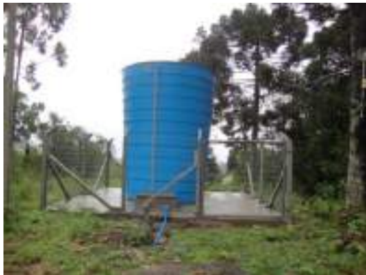
Figura 3.36 – Reservatório do SAA Linha Fernandes 2
