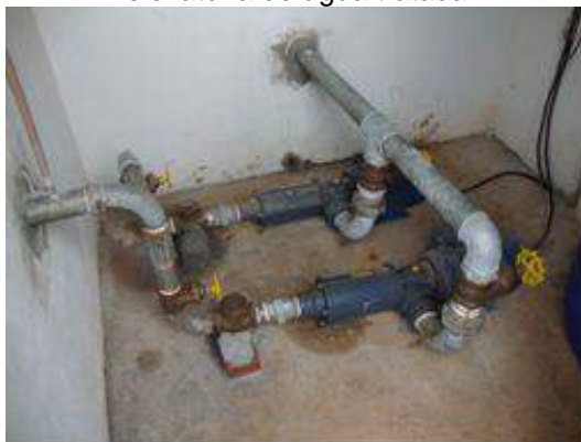
Figura 3.14 – Moto-bombas da estação elevatória de água tratada
