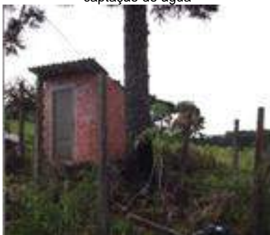
Figura 3.54 – Infraestrutura do ponto de captação de água
