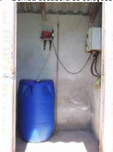
Figura 3.67 – Bomba dosadora de soluções de cloração
