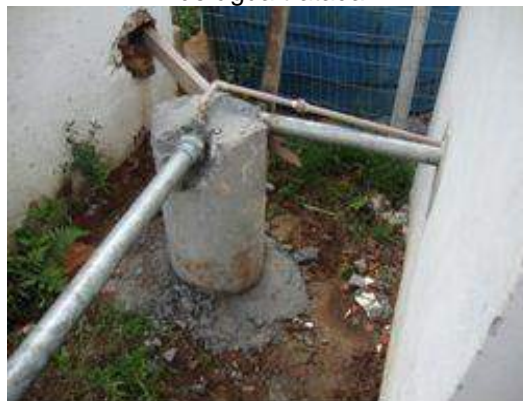
Figura 3.15 - Tubulação da estação elevatória de água tratada
