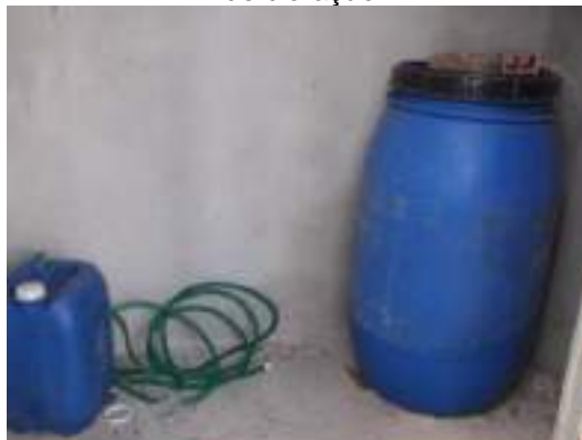
Figura 3.51 – Armazenamento de soluções de cloração
