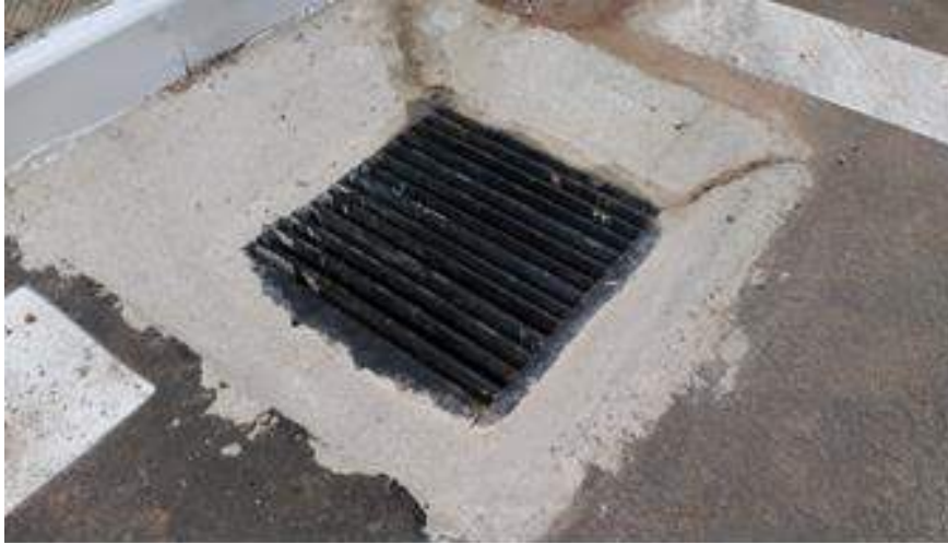
Figura 6.1 – Caixa Coletora (Rua do Posto de Saúde)
