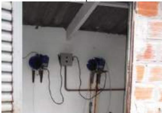
Figura 3.50 - Bomba dosadora de soluções de cloração
