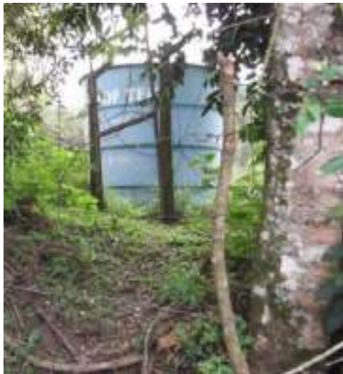
Figura 3.52 – Reservatório do SAA Linha Alto Marcondes
