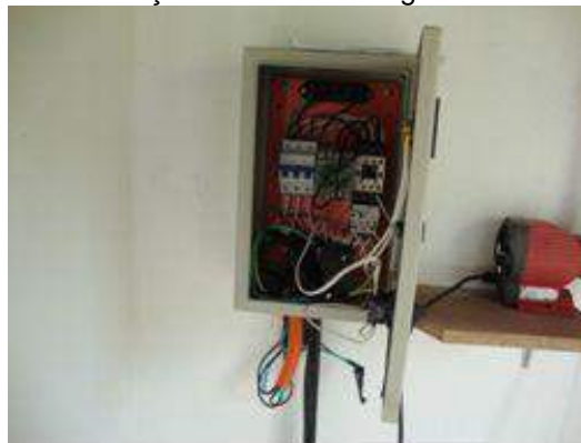
Figura 3.13 – Detalhe do quadro de comando da estação elevatória de água tratada
