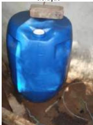
Figura 3.29 - Armazenamento de soluções de cloração
