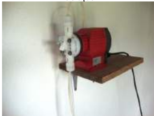
Figura 3.35 - Bomba dosadora de soluções de cloração
