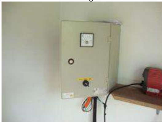
Figura 3.12 – Quadro de comando da estação elevatória de água tratada
