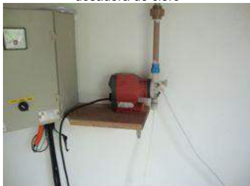
Figura 3.10 - Quadro elétrico e bomba dosadora de cloro
