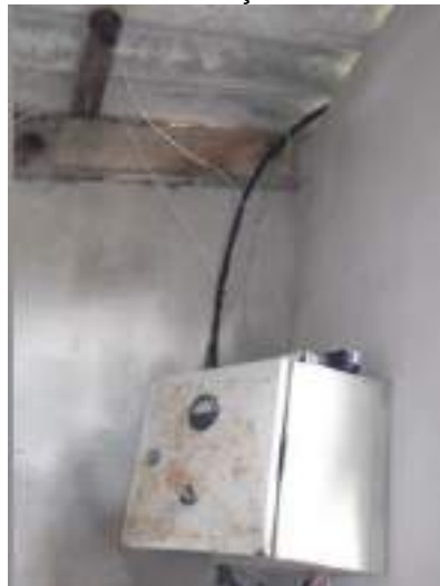
Figura 3.45 –Bomba dosadora de soluções de cloração
