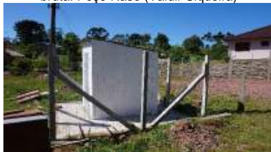
Figura 3.4 - Manancial de captação de água bruta: Poço Raso (Valdir Siqueira)
