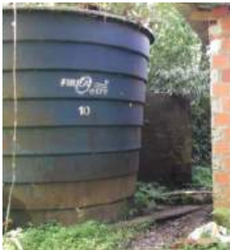
Figura 3.30 – Reservatório I do SAA Linha Fernandes
