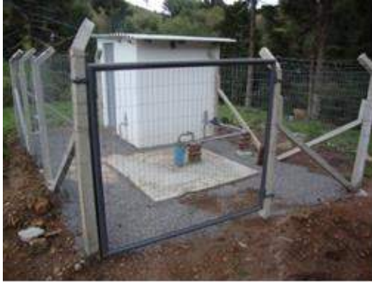
Figura 3.32 – Infraestrutura do ponto de captação da Linha Fernandes 2
