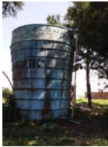
Figura 3.31 – Reservatório II do SAA Linha Fernandes
