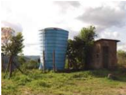
Figura 3.58 – Reservatório do SAA Linha Herval de Baixo
