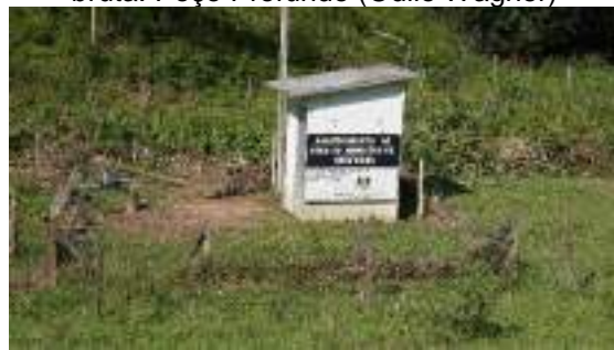
Figura 3.6- Manancial de captação de água bruta: Poço Profundo (Odilo Wagner)
