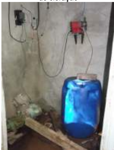
Figura 3.28 - Bomba dosadora de soluções de cloração
