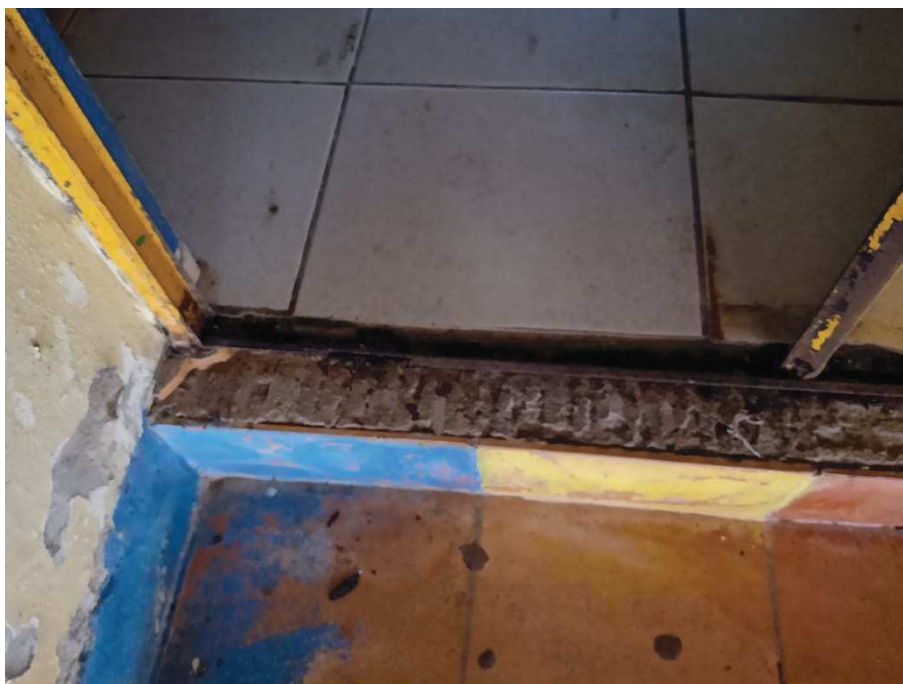
Foto 18 – Porta a ser reformada (foto tirada em 03/02/2021).
