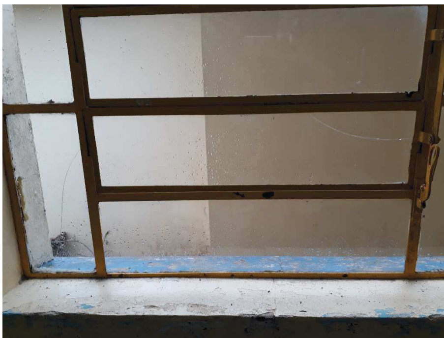
Foto 45 – Vidro trincado a ser substituído (foto tirada em 03/02/2021).
