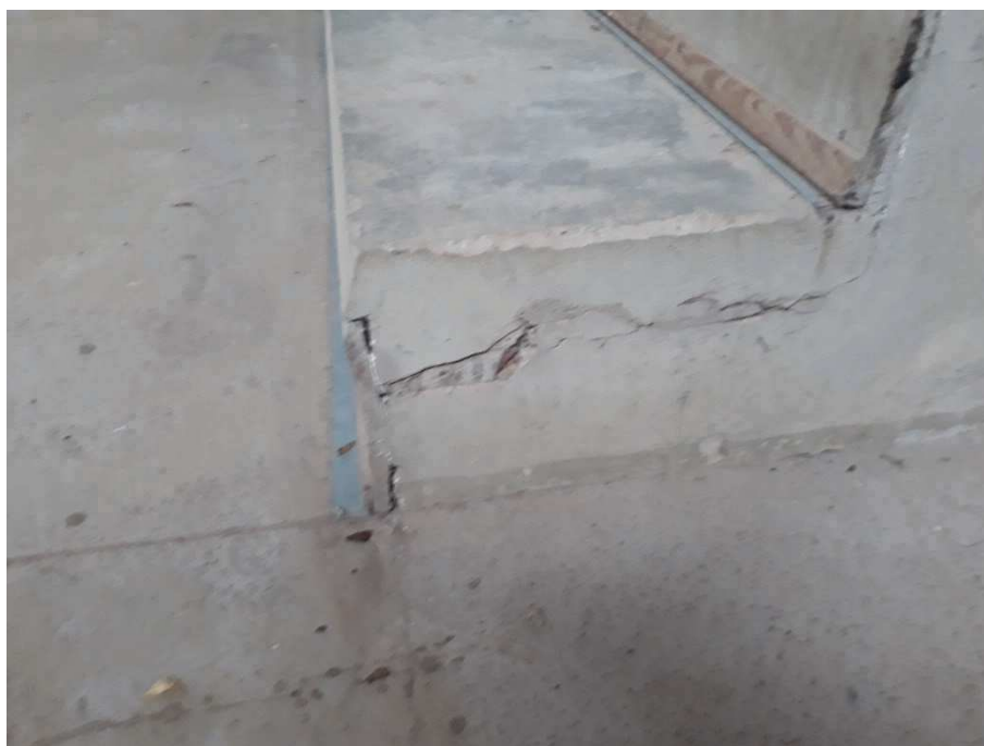
Foto 42 – Revestimento da arquibancada a ser reformado (foto tirada em 03/02/2021).
