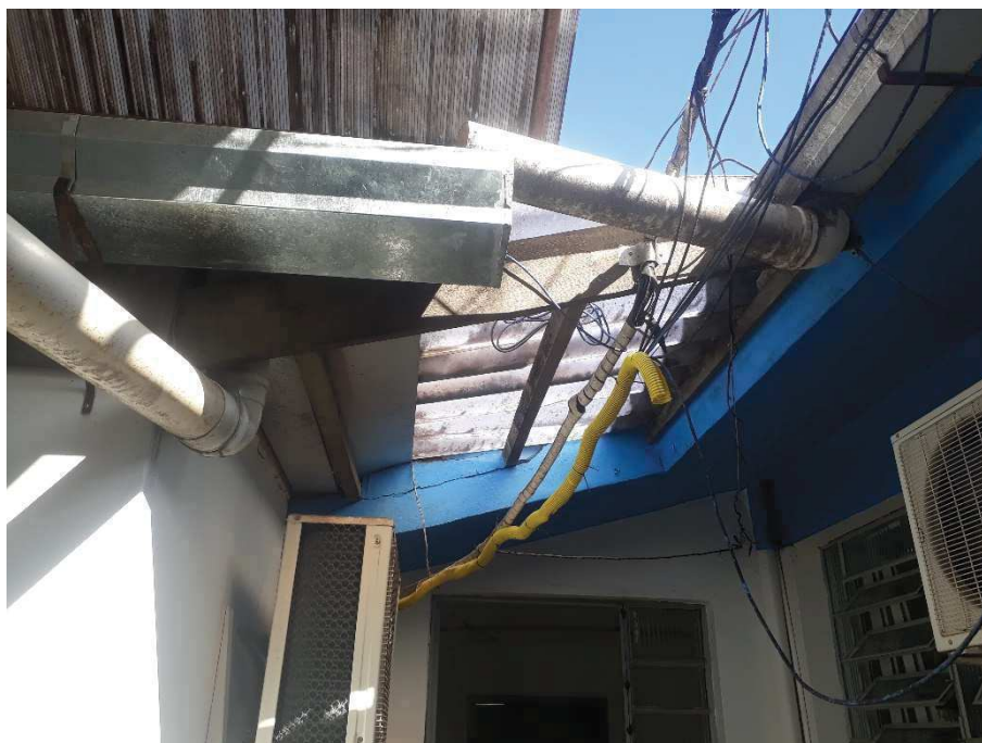
Foto 5 – Telhado a ser substituído por telha de Policarbonato.
