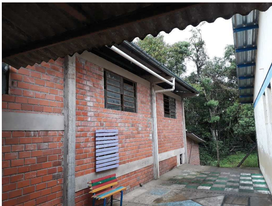
Foto 48 – Vidro do ginásio a ser repostado (foto tirada em 03/02/2021).
