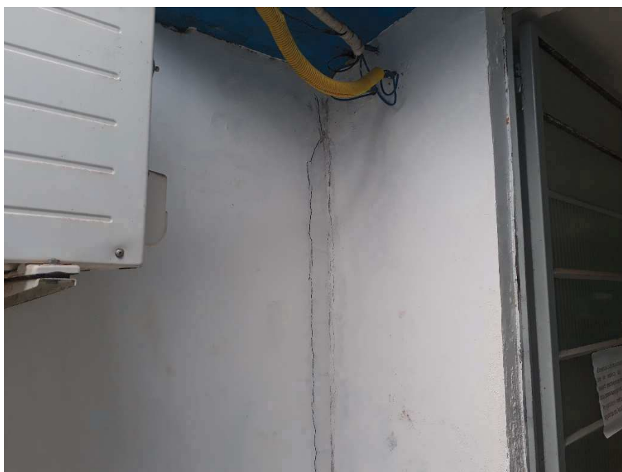
Foto 6 – Fissura em alvenaria a ser “grampeada” e pintada.
