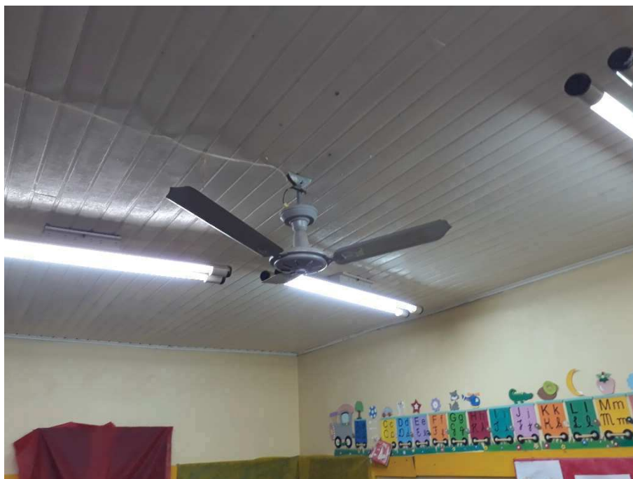
Foto 11 – Ventiladores a serem revisados (foto tirada em 03/02/2021).
