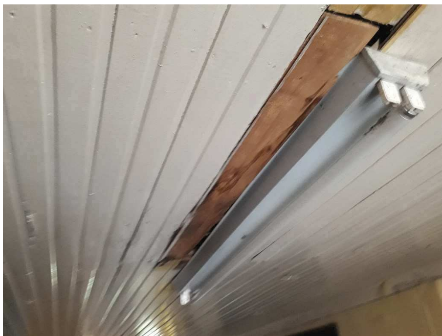
Foto 12 – Fôrro da escola a ser reformado (foto tirada em 03/02/2021).
