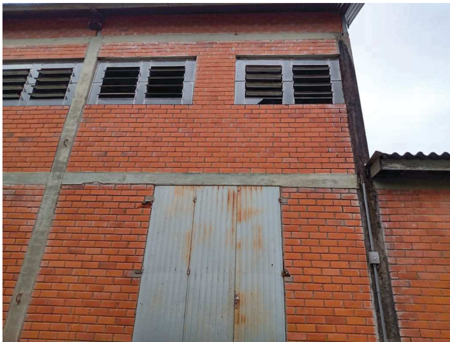
Foto 27 – Vidro quebrado a ser substituído (foto tirada em 03/02/2021).
