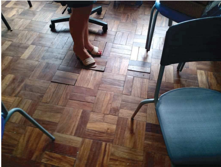
Foto 38 – Local a ser consertado o piso em “Tacos de madeira” (foto tirada em 03/02/2021).
