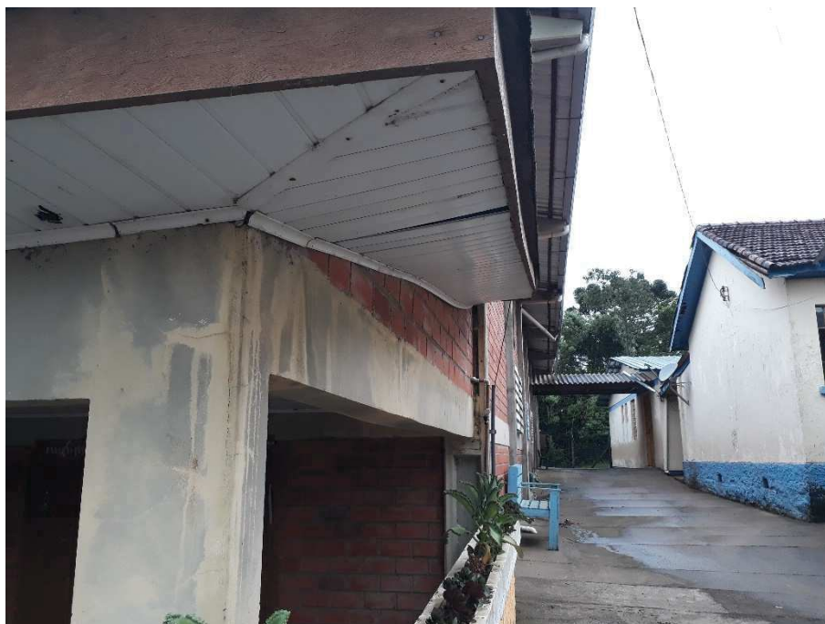
Foto 3 – Beiral do ginásio a ser reformado (foto tirada em 03/02/2021).
