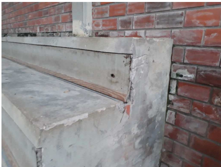
Foto 43 – “Espelho” em madeira da arquibancada a ser reafixado (foto tirada em 03/02/2021).
