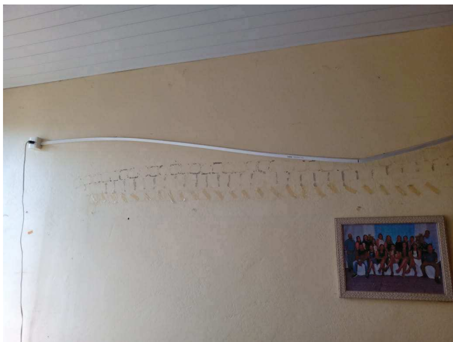
Foto 13 – Eletrocalhas a serem substituídas (foto tirada em 03/02/2021).
