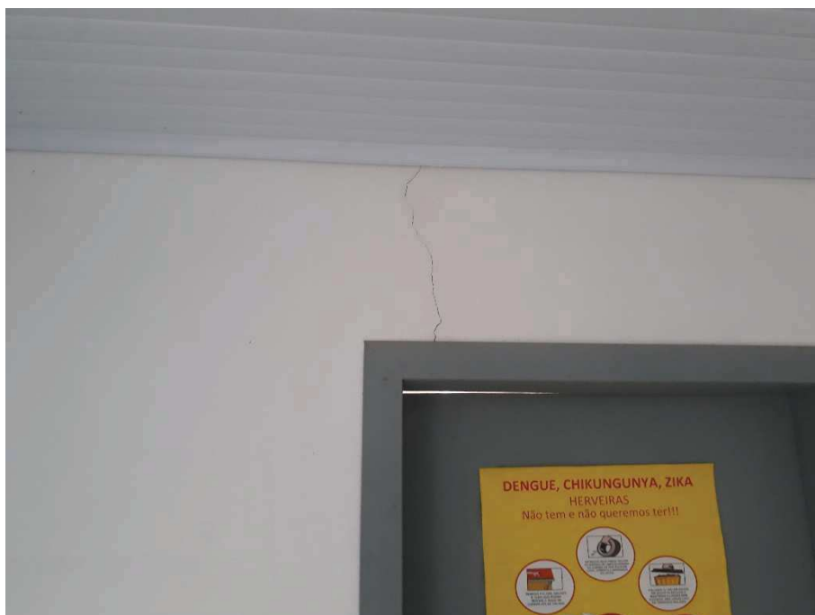
Foto 8 – Fissura em alvenaria a ser “grampeada” e pintada.
