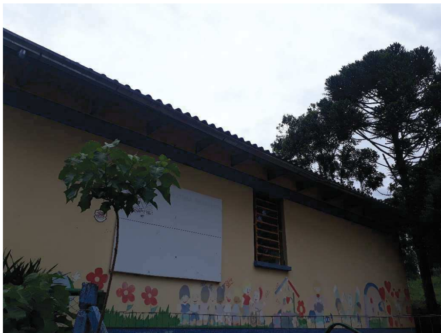
Foto 5 – Calha da escola a ser consertada (foto tirada em 03/02/2021).
