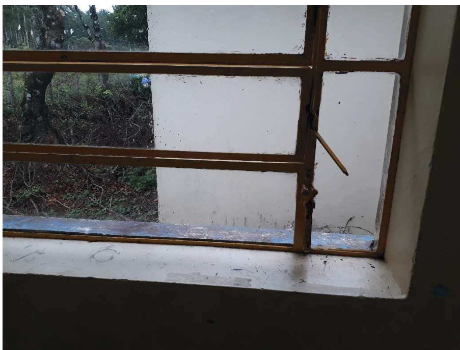
Foto 23 – Janela a ser reformada (foto tirada em 03/02/2021).
