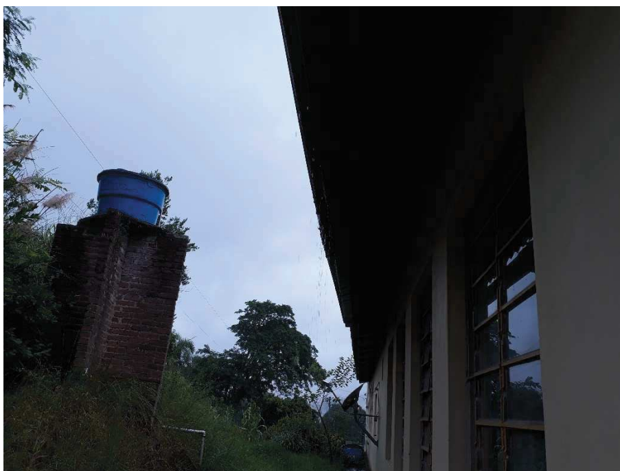
Foto 5 – Calha da escola a ser consertada (foto tirada em 03/02/2021).
