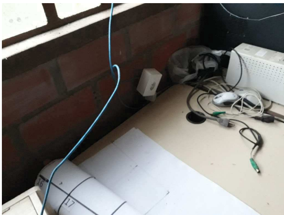
Foto 36 – Tomada a ser substituída (foto tirada em 03/02/2021).
