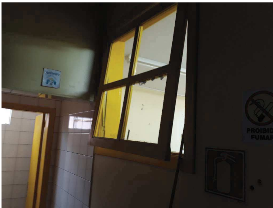
Foto 22 – Janela a ser reformada (foto tirada em 03/02/2021).
