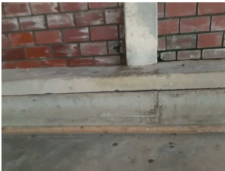
Foto 44 – “Cantoneiras” em madeira da arquibancada a ser reafixado (foto tirada em 03/02/2021).
