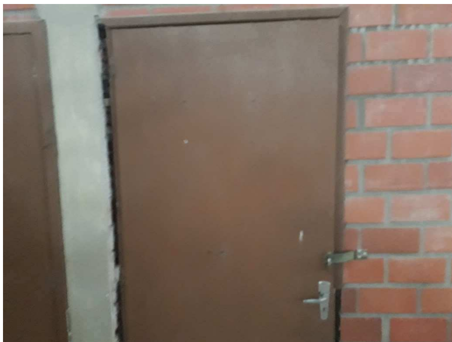
Foto 28 – Porta a ser substituída (foto tirada em 03/02/2021).
