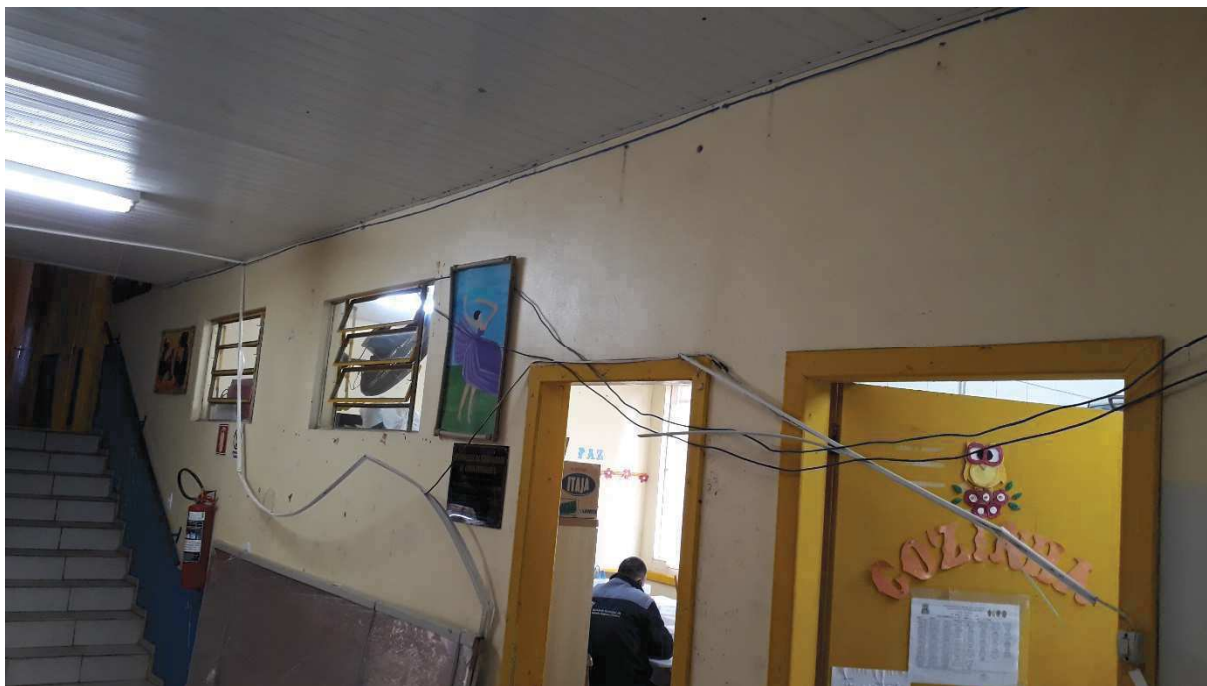
Foto 24 – Local a ser retirada a fiação elétrica e eletrodutos (foto tirada em 03/02/2021).
