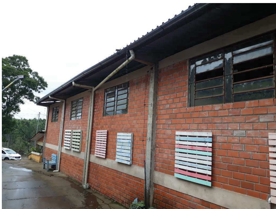
Foto 9 – Calha do ginásio a ser consertada (foto tirada em 03/02/2021).
