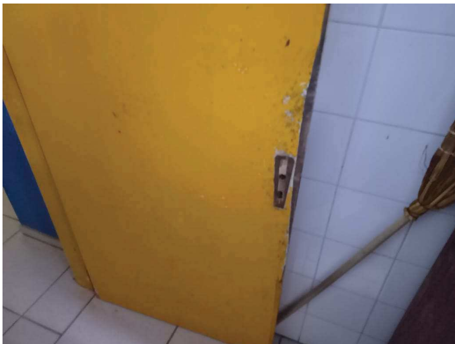
Foto 6 – Porta a ser substituída (foto tirada em 03/02/2021).
