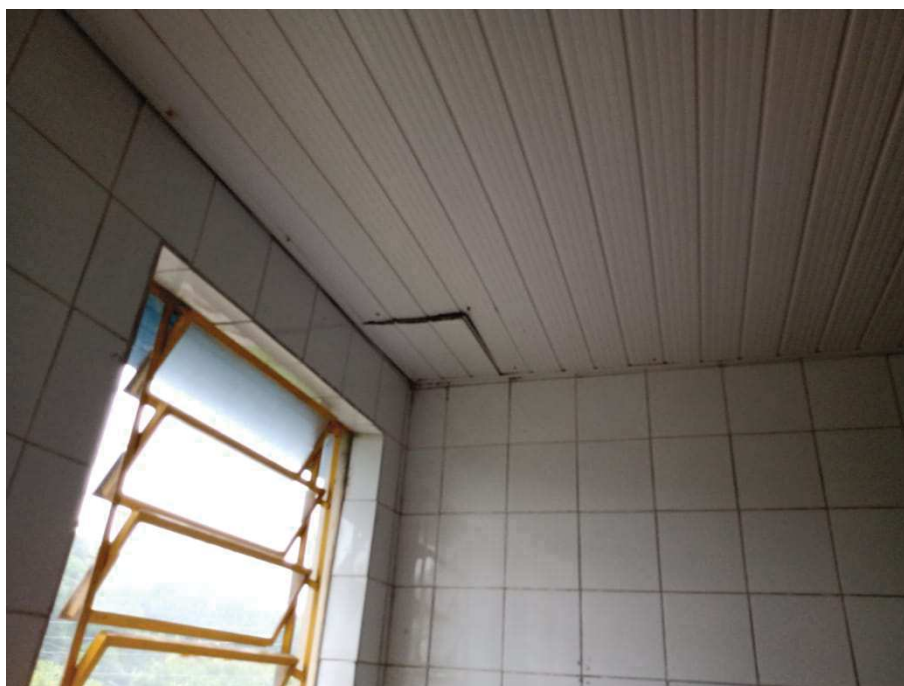
Foto 6 – Fôrro da escola a ser reformado (foto tirada em 03/02/2021).
