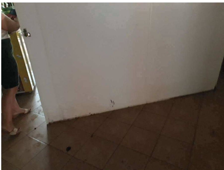
Foto 21 – Divisórias Leves danificadas a serem substituídas (foto tirada em 03/02/2021).
