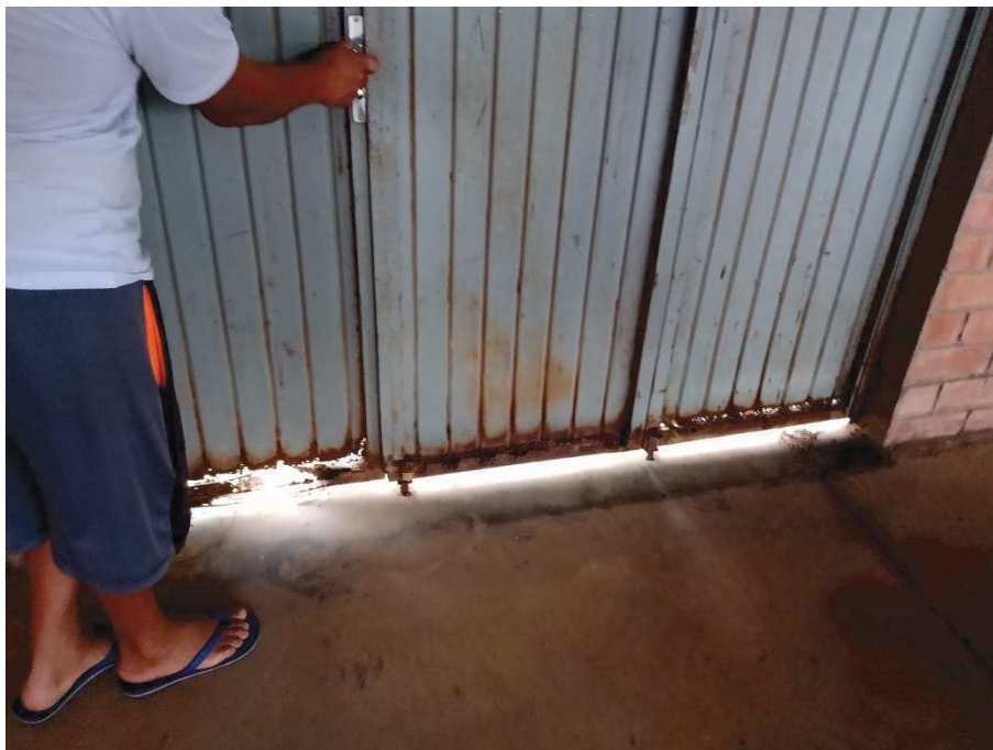
Foto 19 – Porta a ser substituída (foto tirada em 03/02/2021).
