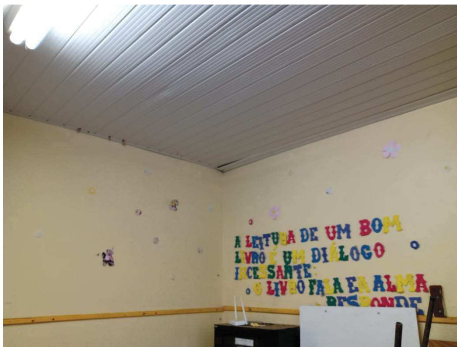
Foto 5 – Fôrro da escola a ser reformado (foto tirada em 03/02/2021).
