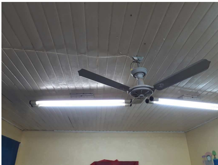
Foto 10 – Ventiladores a serem revisados (foto tirada em 03/02/2021).
