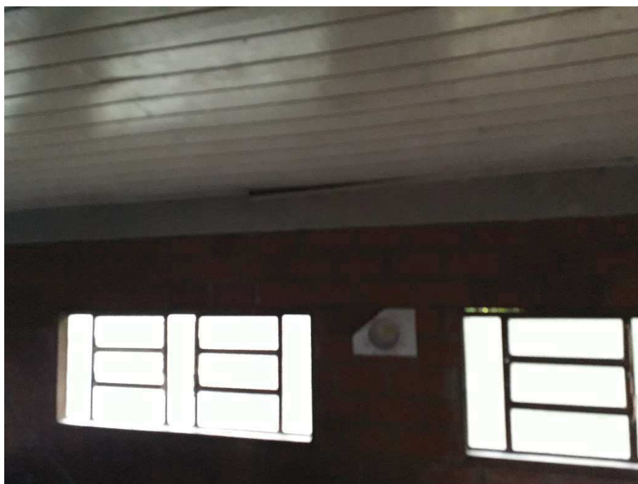
Foto 18 – Fôrro do ginásio a ser fixado (foto tirada em 03/02/2021).
