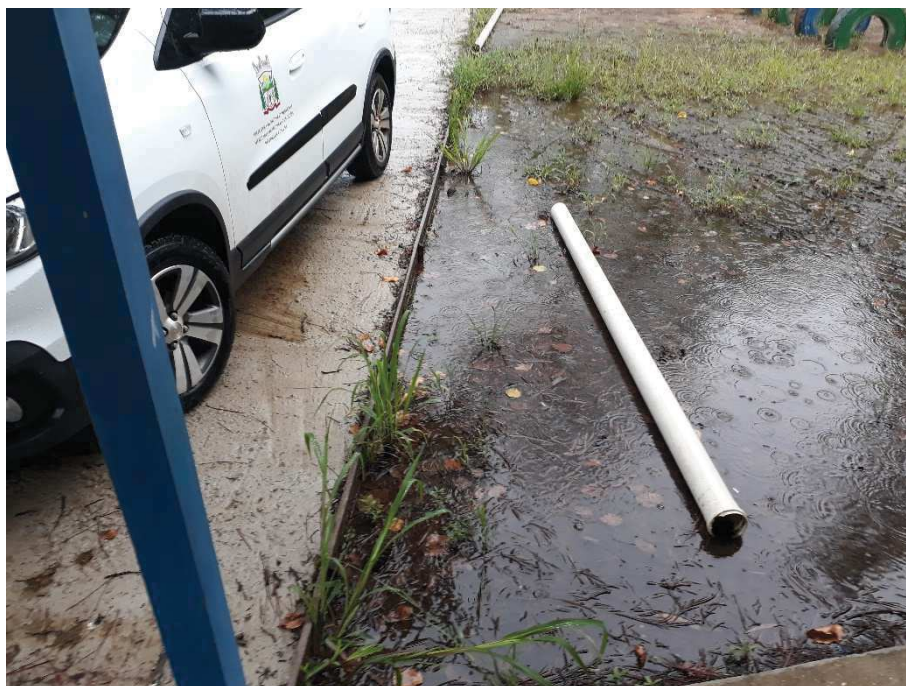
Foto 3 – Locais de instalação de “Caixas de coleta” de águas pluviais (foto tirada em 03/02/2021).
