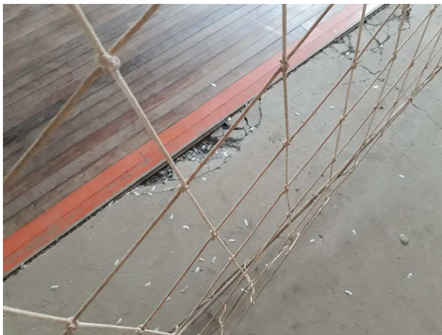
Foto 41 – Piso do entorno da quadra a ser reformado (foto tirada em 03/02/2021).
