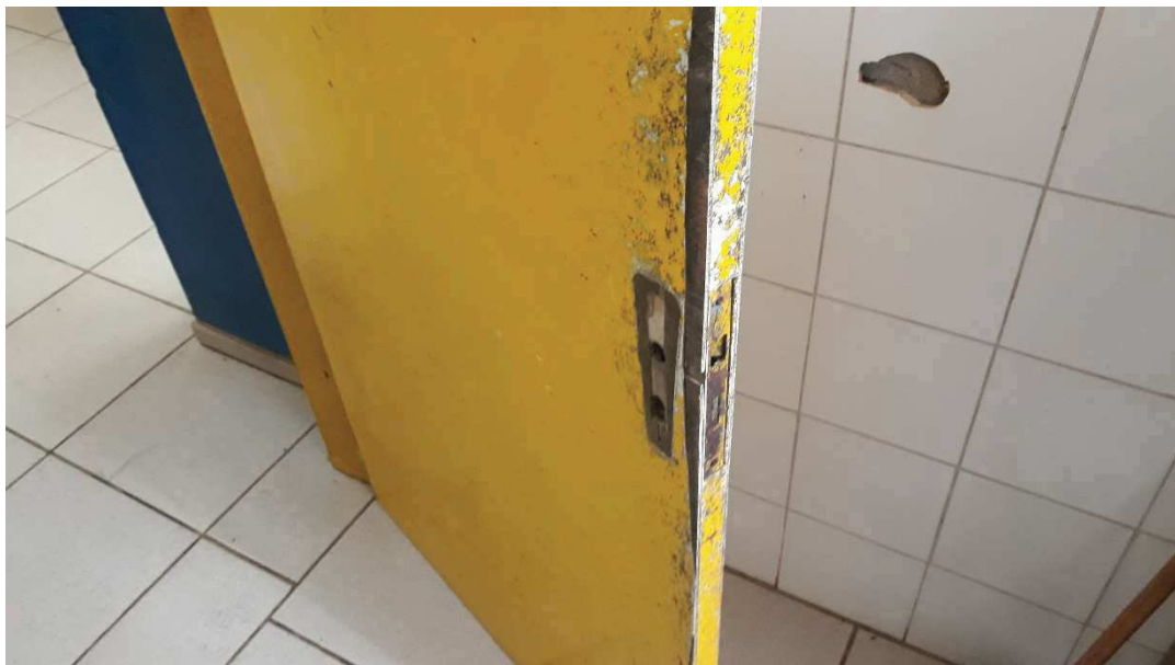
Foto 13 – Porta a ser reformada (foto tirada em 03/02/2021).
