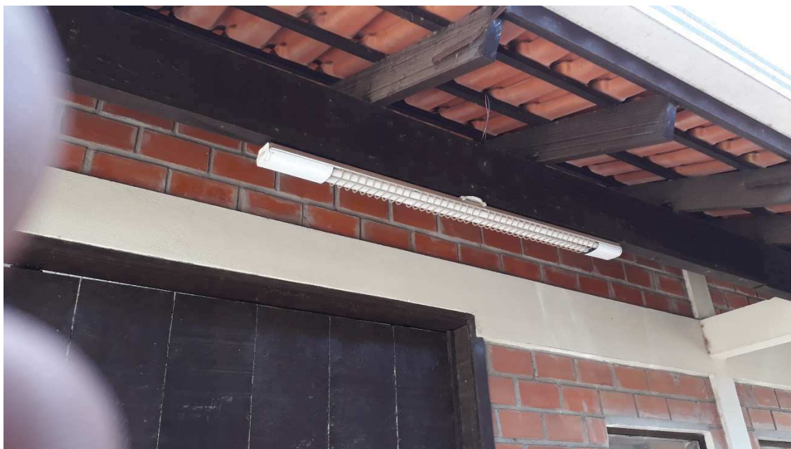
Paredes externas e madeiramento a serem pintados (foto tirada em 09/12/2019).
