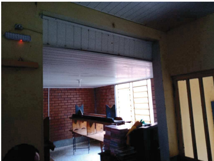
Foto 4 – Local a ser reformado o fôrro (foto tirada em 03/02/2021).
