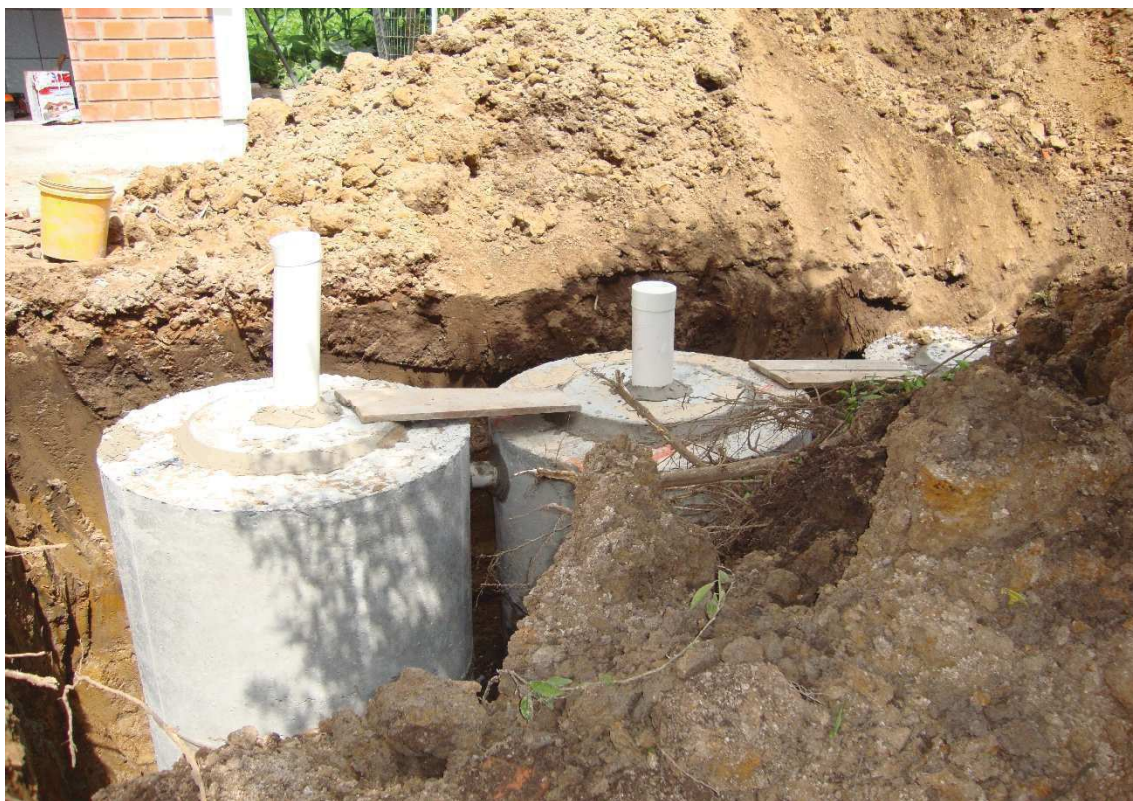
Local dos dispositivos de despejo do esgoto cloacal (foto tirada durante a execução em 19/12/2012).
