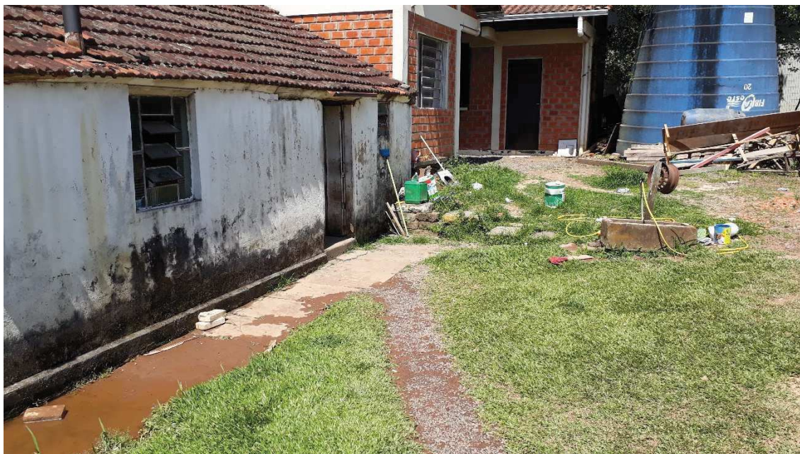
Local a ser executado o piso em lajotas de concreto (foto tirada em 09/12/2019).
