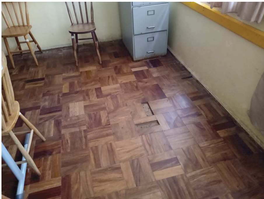
Foto 39 – Local a ser consertado o piso em “Tacos de madeira” (foto tirada em 03/02/2021).
