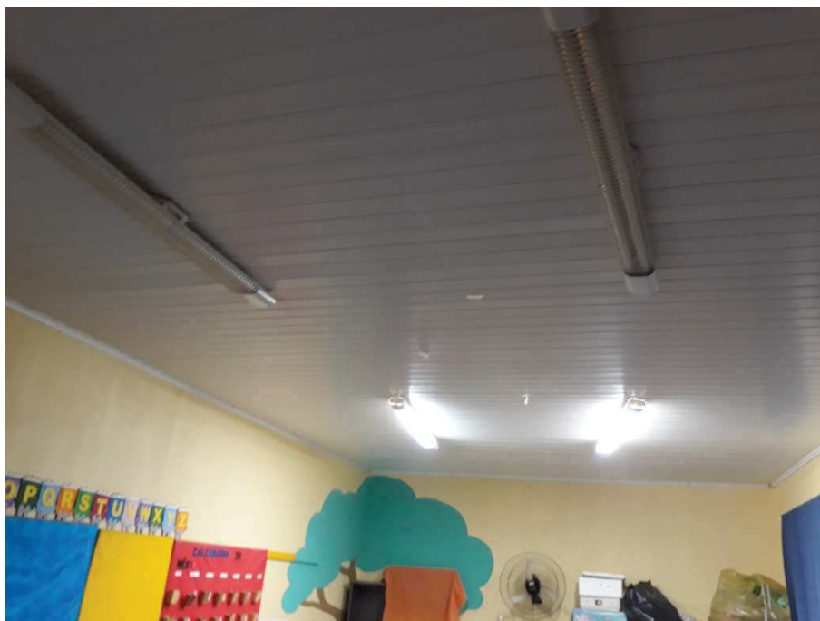
Foto 12 – Luminárias a serem substituídas (foto tirada em 03/02/2021).
