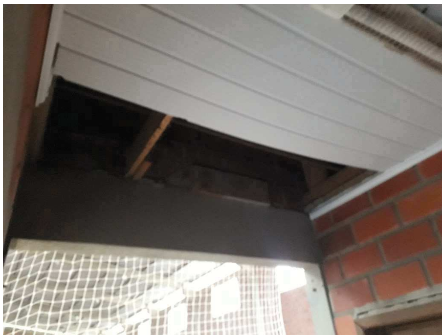
Foto 19 – Fôrro do ginásio a ser refeito em PVC (foto tirada em 03/02/2021).
