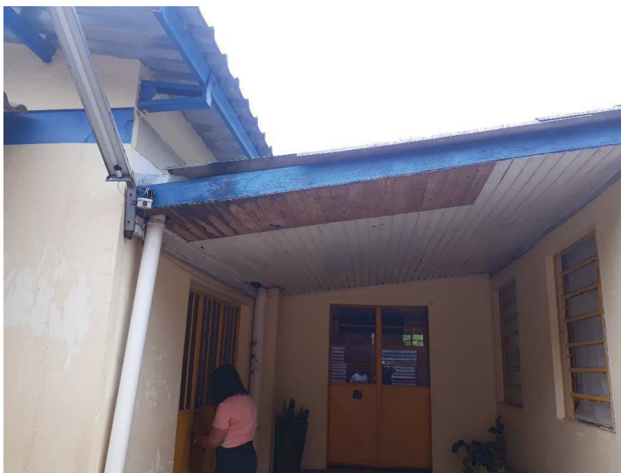
Foto 10 – Local a ser reformado o fôrro (foto tirada em 03/02/2021).
