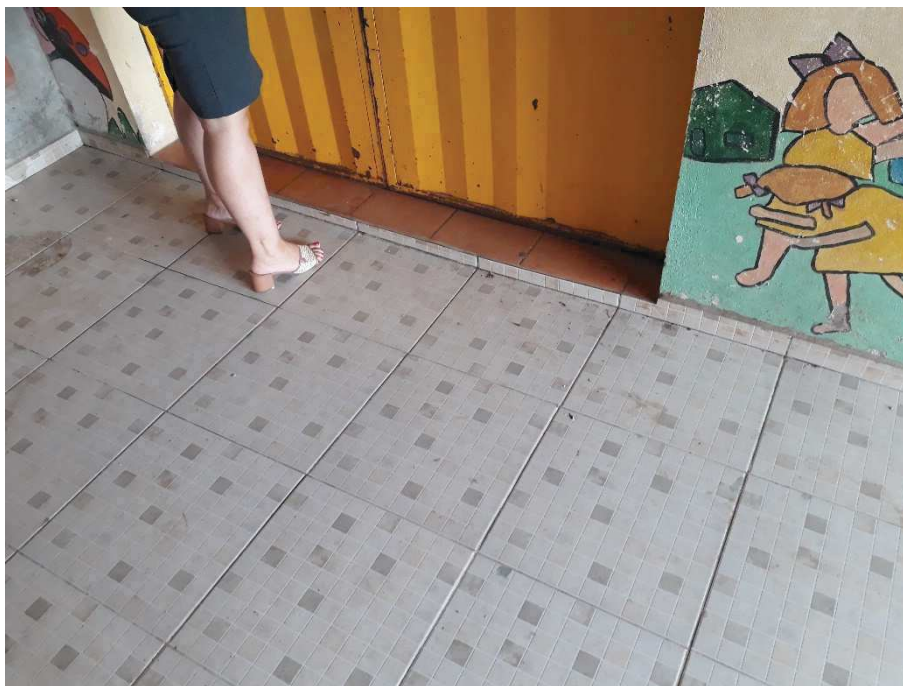
Foto 34 – Local a ser construída a rampa de acesso à escola (foto tirada em 03/02/2021).
