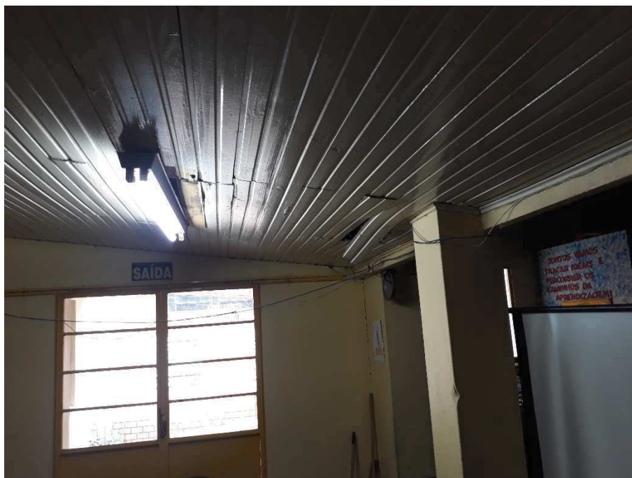
Foto 13 – Fôrro da escola a ser reformado (foto tirada em 03/02/2021).
