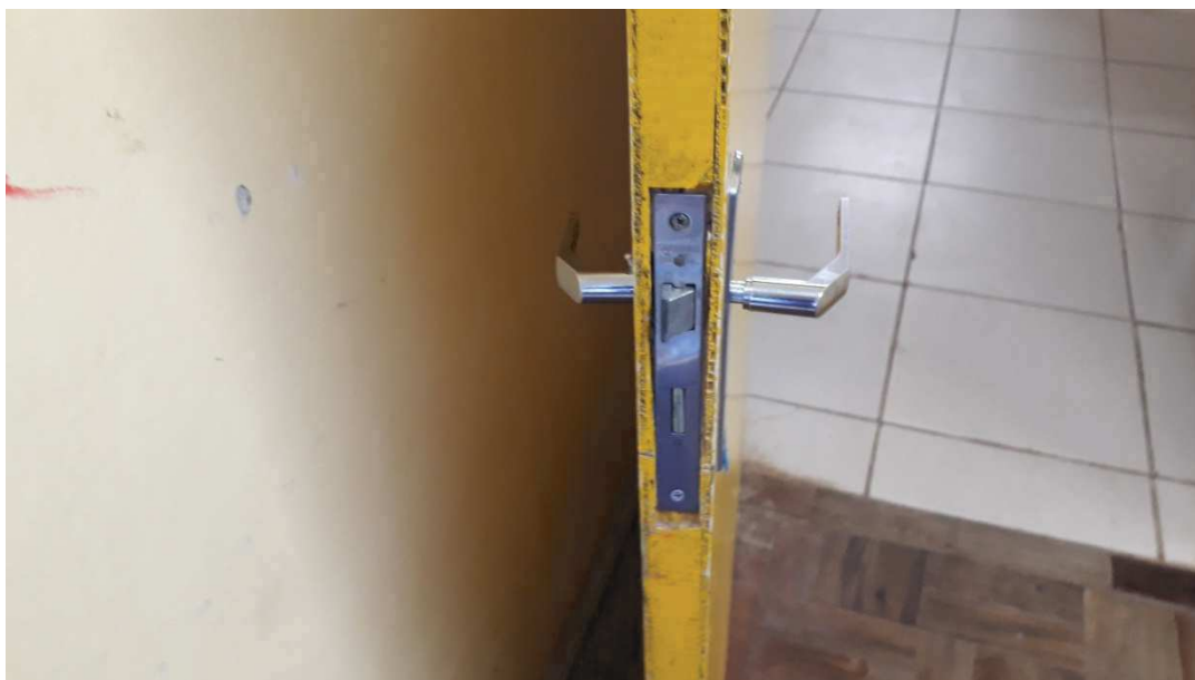
Foto 12 – Porta a ser reformada (foto tirada em 03/02/2021).
