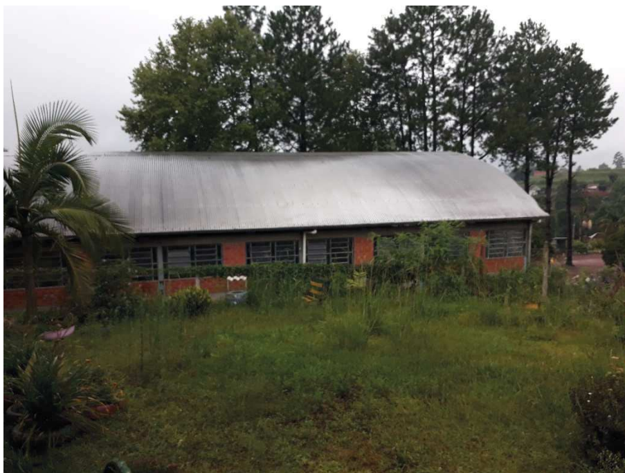
Foto 4 – Calha do ginásio a ser limpa e consertada (foto tirada em 03/02/2021).
