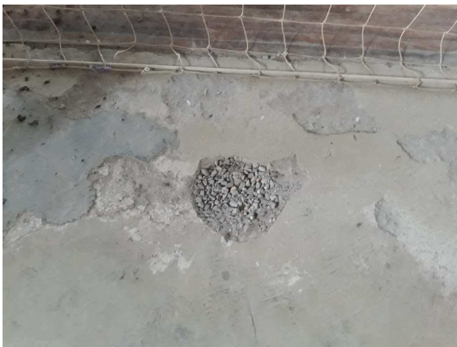
Foto 40 – Piso do entorno da quadra a ser reformado (foto tirada em 03/02/2021).
