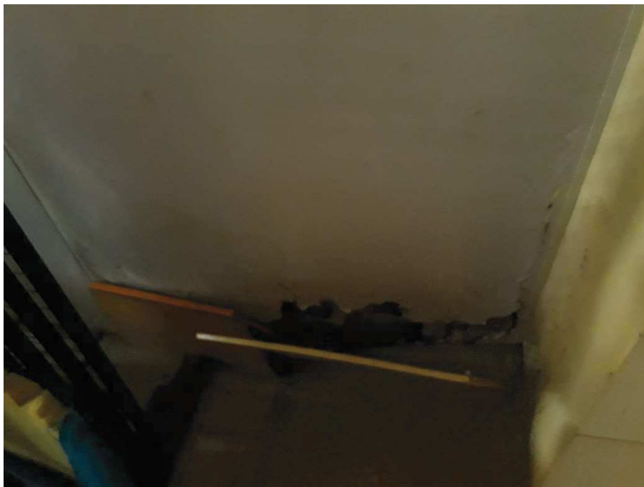
Foto 20 – Divisórias Leves danificadas a serem substituídas (foto tirada em 03/02/2021).
