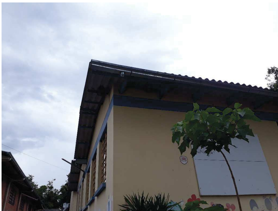
Foto 6 – Calha da escola a ser consertada (foto tirada em 03/02/2021).
