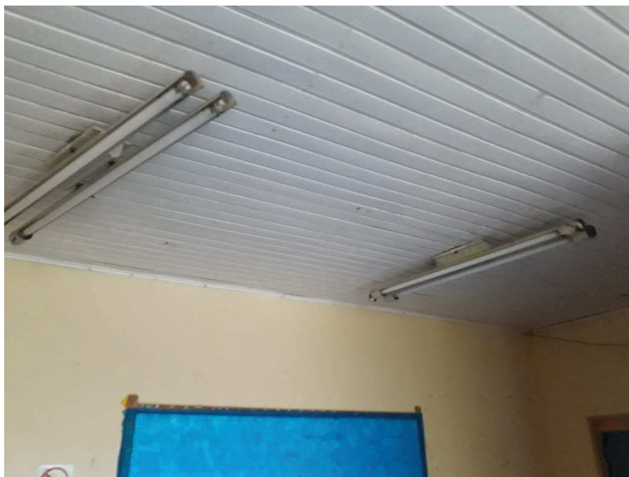
Foto 8 – Luminárias a serem substituídas (foto tirada em 03/02/2021).
