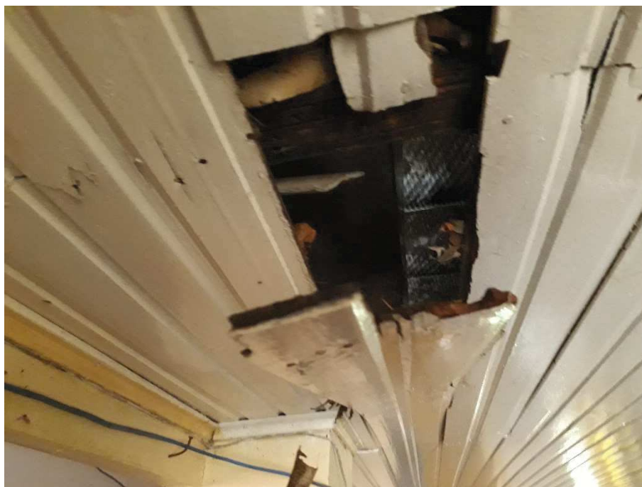
Foto 11 – Fôrro da escola a ser reformado (foto tirada em 03/02/2021).
