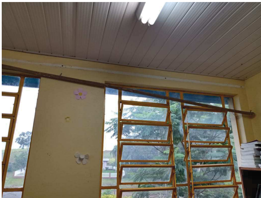
Foto 28 – Vidro trincado a ser substituído e fixação do “trilho” da cortina (foto tirada em 03/02/2021).
