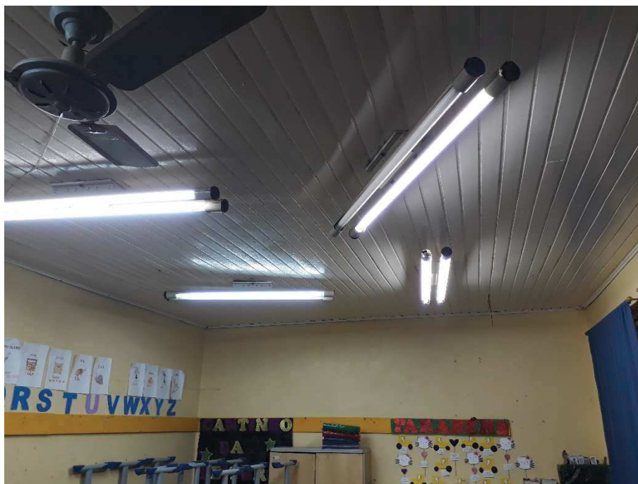
Foto 9 – Luminárias a serem substituídas (foto tirada em 03/02/2021).
