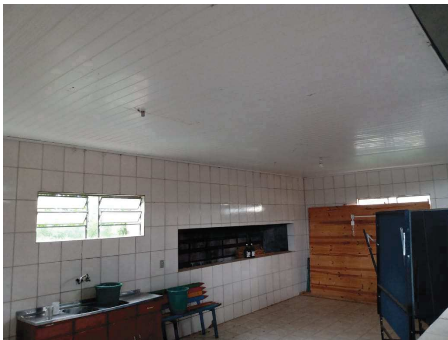
Foto 23 – Instalações elétricas do ginásio a serem revisadas (foto tirada em 03/02/2021).
