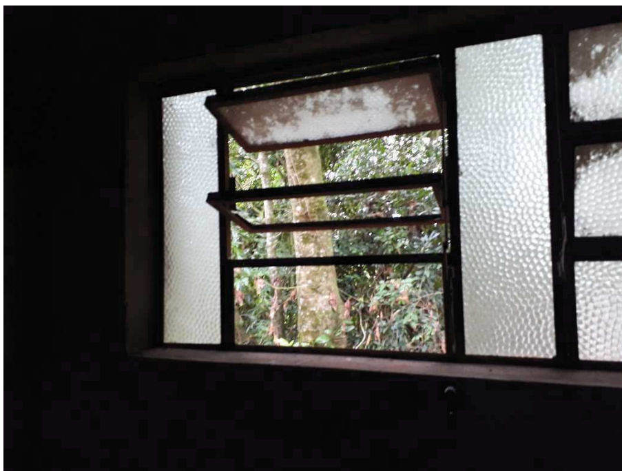
Foto 50 – Vidro do banheiro do ginásio a ser repostado (foto tirada em 03/02/2021).
