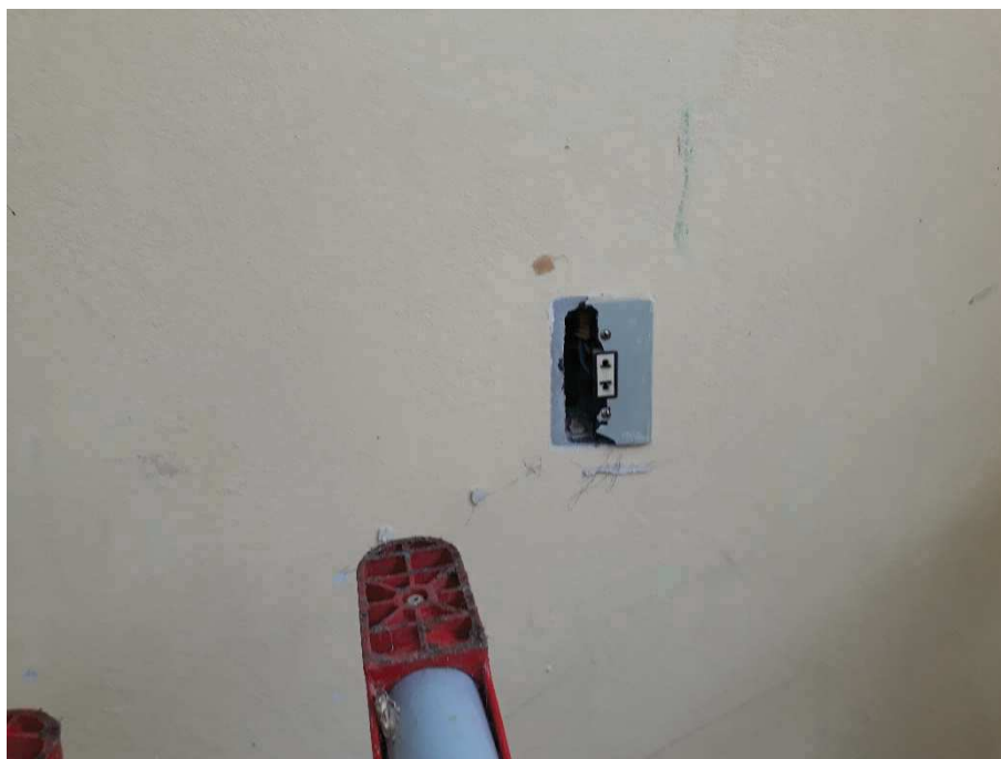
Foto 35 – Tomada a ser substituída (foto tirada em 03/02/2021).
