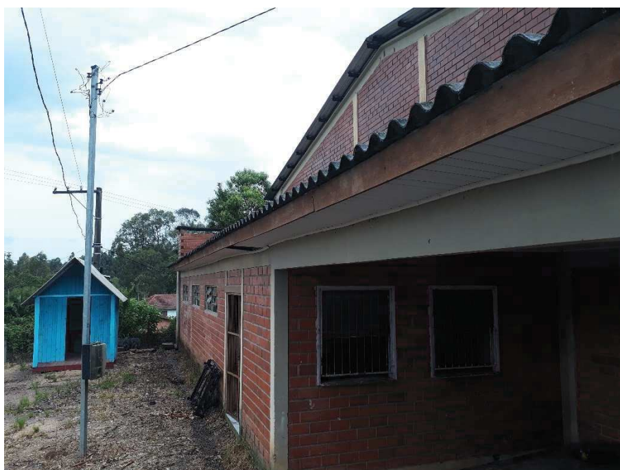
Foto 4 – Beiral do ginásio a ser reformado (foto tirada em 03/02/2021).
