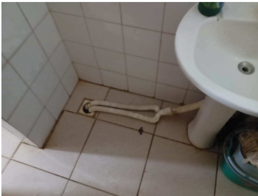
Foto 25 – Local a ser arrumada a canalização e colocada tampa no “ralo” (foto tirada em 03/02/2021).
