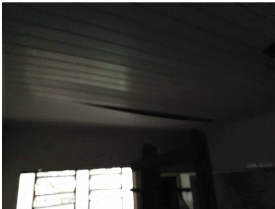
Foto 17 – Fôrro do ginásio a ser fixado (foto tirada em 03/02/2021).
